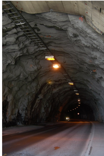
Figur 6: Kabelstige i tunneltak i Flekkerøytunnelen. Foto Kjell Wold
