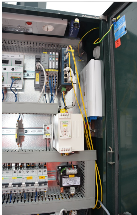
Måler plassert i fordelingskap. Foto: Tore Paulsen
