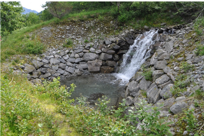
Figur 7: Sikring for sørpeskred/flomskred. Foto: Marie Drågen
