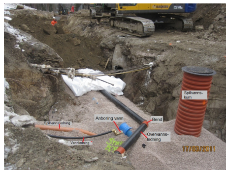
Rørledninger. Foto Terje Rønneberg
