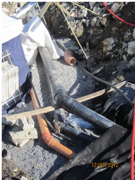
Rørledninger med bend. Foto Terje Rønneberg
