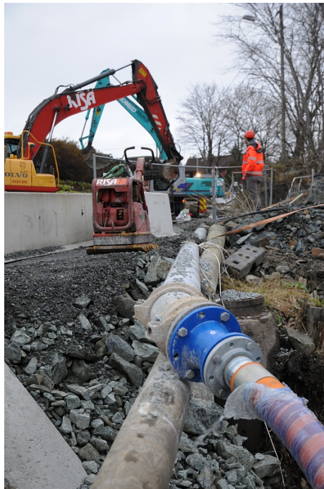
Rørledninger tilhørende veganlegg: Foto: Anja Kristin Bakken
