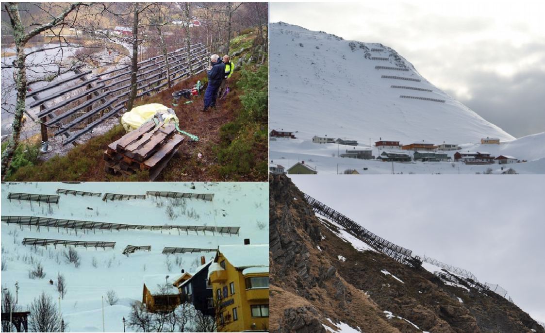
Eksempler på støtteforbygninger. Foto NGI (øverst til venstre), Jan Otto Larsen (øverst til høyre), Statens vegvesen (nederst)
