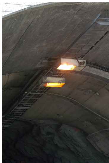
Lysarmaturer i Tunnel. Foto Kjell Wold
