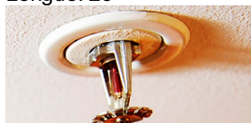
Brannslukking med sprinkleranlegg i tak
