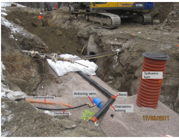
Figur 5: Rørledninger. Foto Terje Rønneberg
