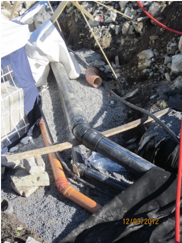
Figur 6: Rørledninger med bend. Foto Terje Rønneberg
