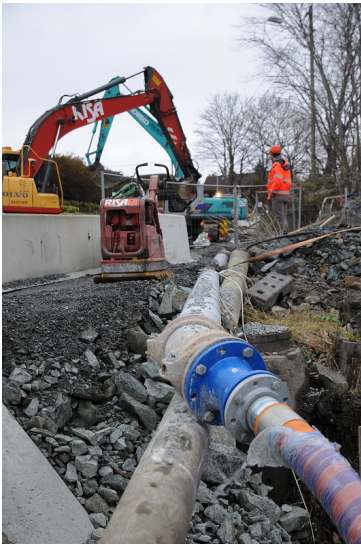
Figur 4: Rørledninger tilhørende veganlegg. Foto: Anja Kristin Bakken
