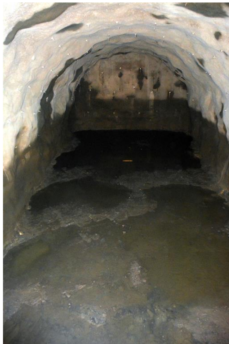
Pumpesump: Foto: Tore Paulsen
