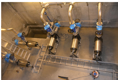
Pumpestasjon i Tunnel. Foto Tore Paulsen
