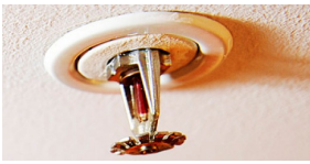
Brannslukking med sprinkleranlegg i tak
