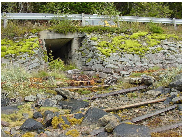
Figur 6: Stikkrenne. Foto: Per Gevik
