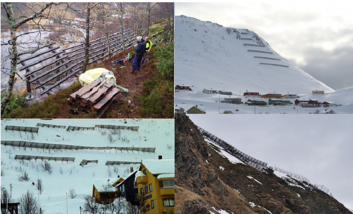
Eksempler på støtteforbygninger. Foto NGL (øverst til venstre), Jan Otto Larsen (øverst til høyre), Statens vegvesen (nederst)
