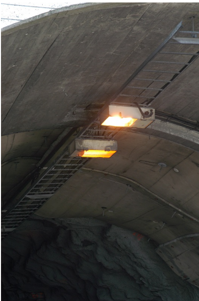
Lysarmaturer i Tunnel. Foto Kjell Wold
