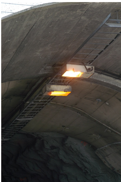
Lysarmaturer i Tunnel. Foto Kjell Wold
