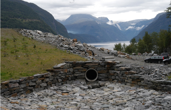
Figur 3: Skredmagasin. Foto: Geir Brække
