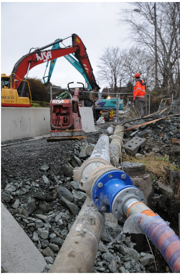
Figur 4: Rørledninger tilhørende veganlegg. Foto: Anja Kristin Bakken
