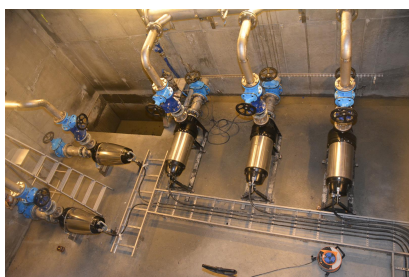
Pumpestasjon i Tunnel. Foto Tore Paulsen
