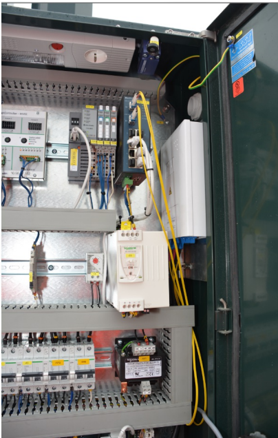
Måler plassert i fordelingssskap. Foto: Tore Paulsen
