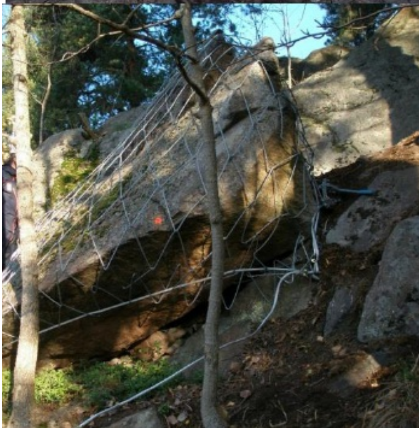
Foto: Betongrenovering AS, K.Moen, Multiconsult AS Øverst "Ubåtnett", nederst wirennett
