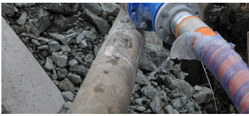
Figur 4: Rørledninger tilhørende veganlegg. Foto: Anja Kristin Bakken
