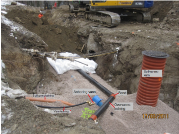
Figur 5: Rørledninger. Foto Terje Rønneberg
