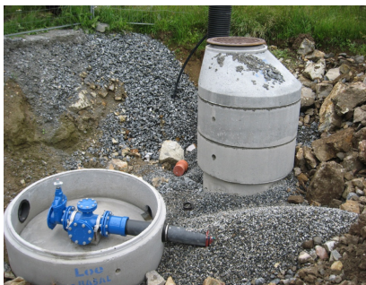
Vannkummer. Foto Terje Rønneberg
