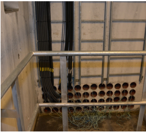
Trekkerør inn til hovedfordeling. Foto: Tore Paulsen
