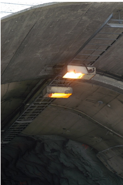
Lysarmaturer i Tunnel. Foto Kjell Wold
