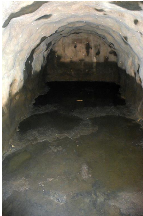
Pumpesump: Foto: Tore Paulsen
