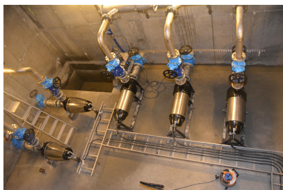
Pumpestasjon i Tunnel. Foto Tore Paulsen
