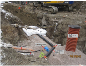
Figur 5: Rørledninger. Foto Terje Rønneberg
