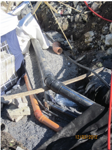
Figur 6: Rørledninger med bend. Foto Terje Rønneberg
