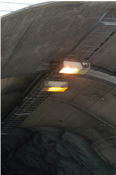
Lysarmaturer i Tunnel. Foto Kjell Wold
