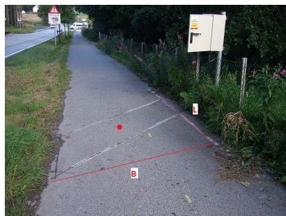
{Detektor, trafikk} med induktiv sløyfe for sykkel. Rødt punkt viser hvor geometri skal registreres
