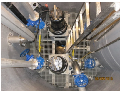
Pumpestasjon i kum. Foto: Terje Rønneberg
