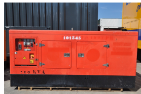
Stasjonært strømaggregat. Foto: Bredenoord
