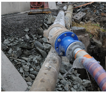
Figur 4: Rørledninger tilhørende veganlegg. Foto: Anja Kristin Bakken
