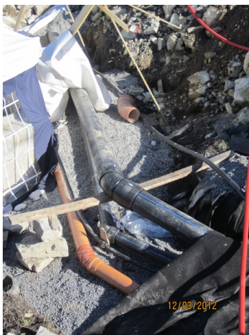
Figur 6: Rørledninger med bend. Foto Terje Rønneberg
