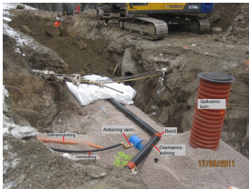
Figur 5: Rørledninger. Foto Terje Rønneberg
