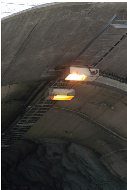
Lysarmaturer i Tunnel. Foto Kjell Wold
