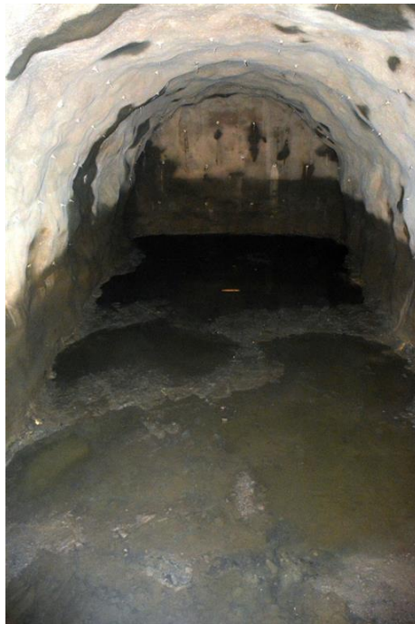
Pumpesump: Foto: Tore Paulsen
