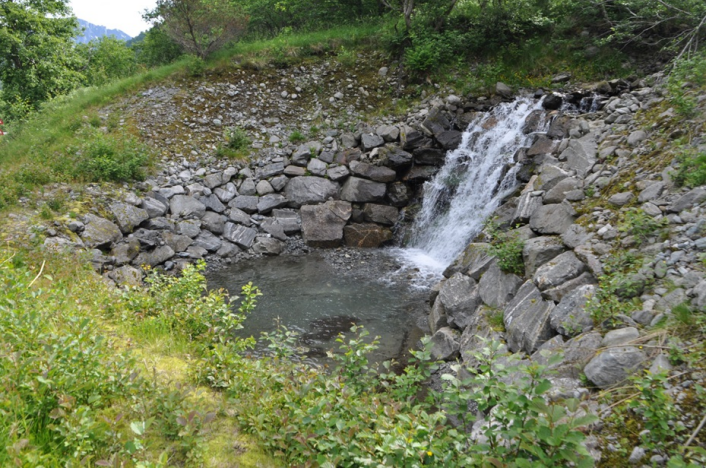
Figur 7: Sikring for sørpeskred/flomskred. Foto: Marie Drågen
