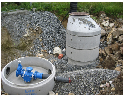
Vannkummer. Foto Terje Rønneberg
