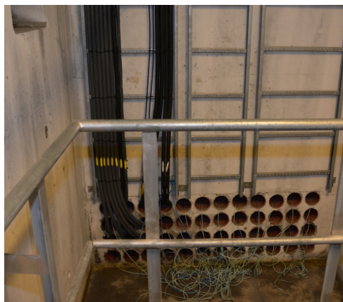
Trekkerør inn til hovedfordeling. Foto: Tore Paulsen
