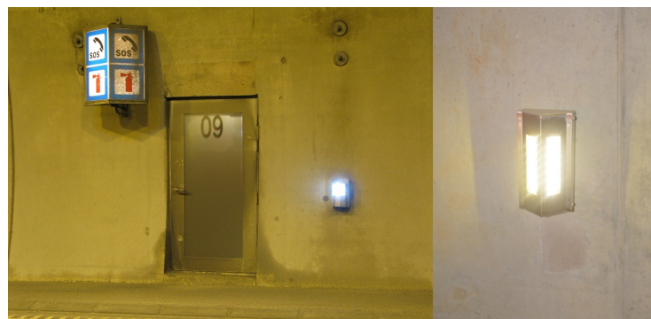
Evakueringslys i tunnel. Foto: Statens Vegvesen og Tore Paulsen
