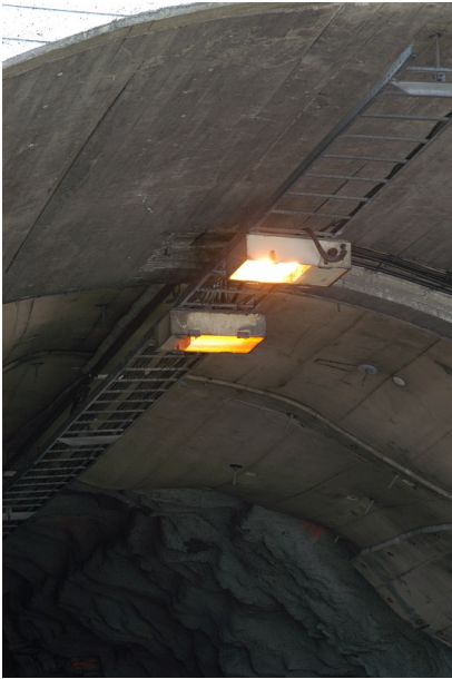
Lysarmaturer i Tunnel. Foto Kjell Wold
