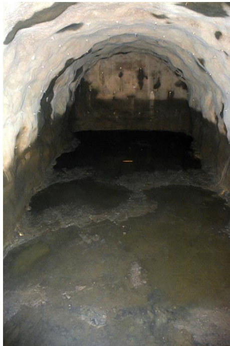
Pumpesump: Foto: Tore Paulsen
