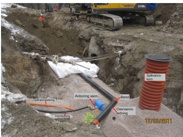
Figur 5: Rørledninger. Foto Terje Rønneberg
