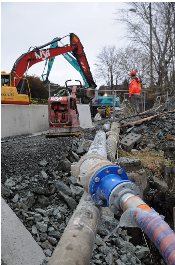
Figur 4: Rørledninger tilhørende veganlegg. Foto: Anja Kristin Bakken
