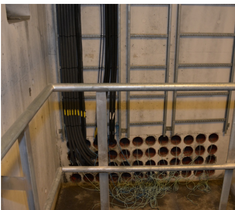
Trekkerør inn til hovedfordeling. Foto: Tore Paulsen
