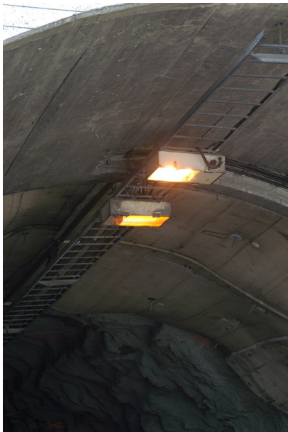
Lysarmaturer i Tunnel. Foto Kjell Wold
