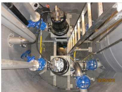
Pumpestasjon i kum. Foto: Terje Rønneberg
