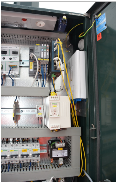
Måler plassert i fordelingsskap. Foto: Tore Paulsen
