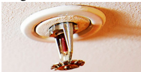
Brannslukking med sprinkleranlegg i tak
