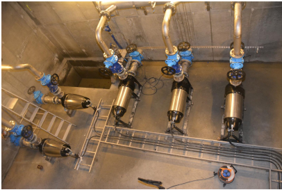
Pumpestasjon i Tunnel. Foto Tore Paulsen
