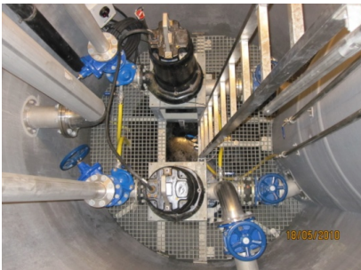
Pumpestasjon i kum. Foto: Terje Rønneberg
