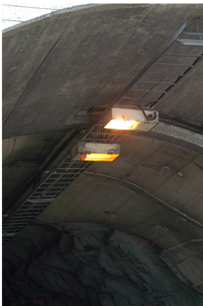
Lysarmaturer i Tunnel. Foto Kjell Wold
