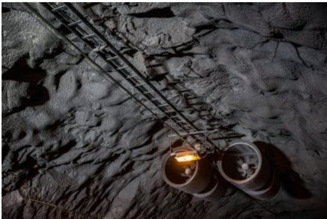
Figur 1 Ventilasjonsanlegg (Foto: Silje Drevdal, Statens vegvesen)
