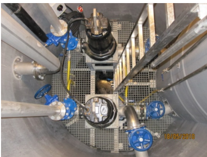
Pumpestasjon i kum. Foto: Terje Rønneberg
